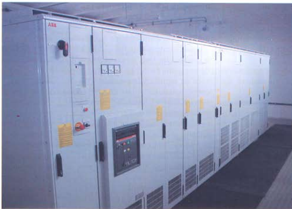
Fig. 2. Convertizorul de frecvență de 1120 kVA
